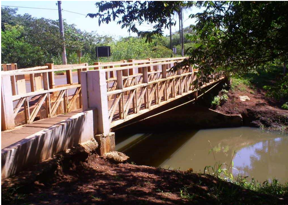
Figura 16 – Ponte construída na década de 1970, executada pelo antigo DNR, hoje DNIT, implantação feita pelo Estado.
