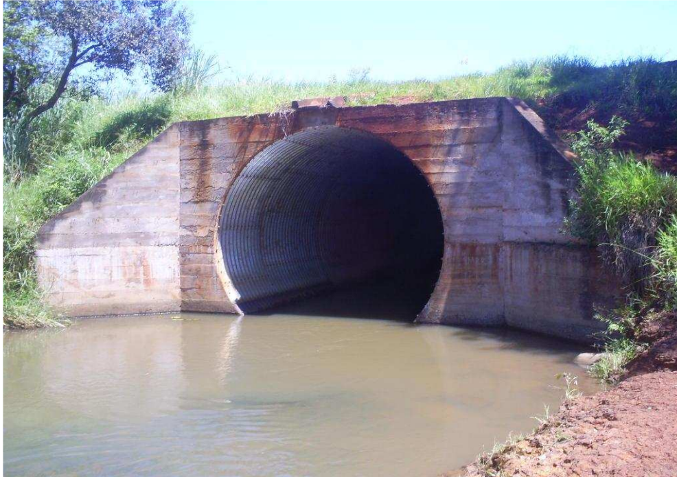
Figura 14 – Bueiro construído na década de 1970, executada pelo antigo DNR, hoje DNIT, implantação feita pelo Estado. Coordenadas geográficas = Lat: -21°49'27, 857"S" Long: -54°31'50, 946" w" Foto: OLIVEIRA (2008).
