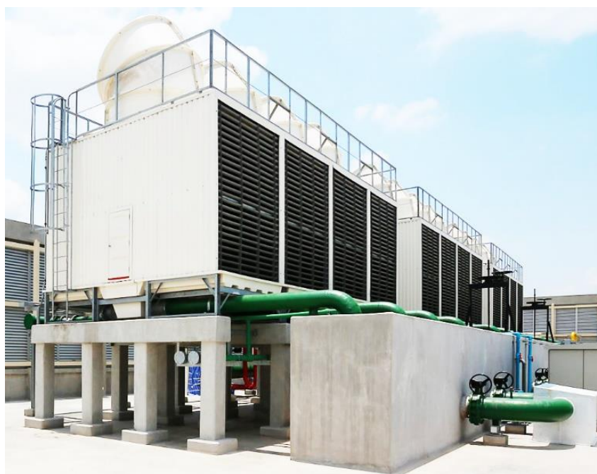
Figura 5 – Torre de resfriamento mecânica
