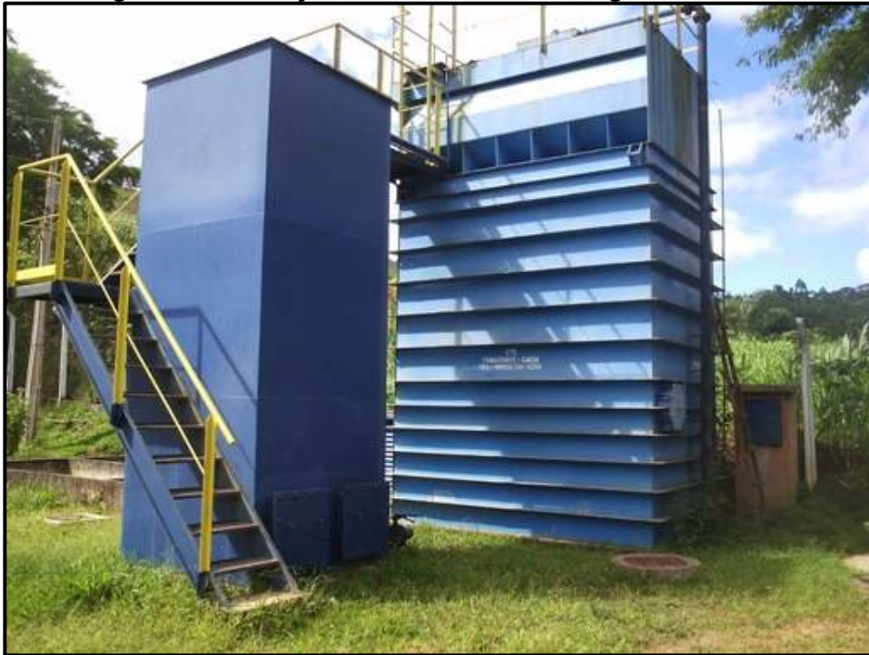
Figura 59 - Estação de tratamento de esgoto – Violeira
