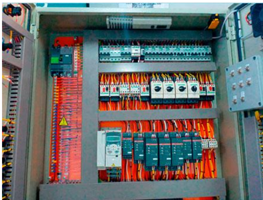
Figura 1 – Painel de comandos elétricos automatizado com CLP
